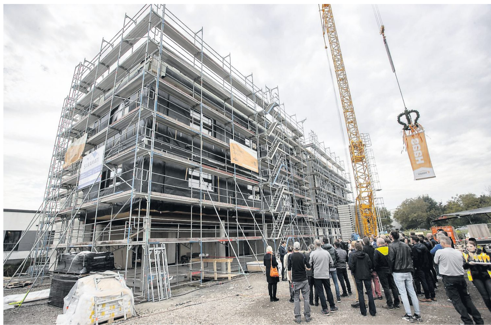
Die Firma Dioptric feierte Richtfest im Technologiepark. Auf drei Stockwerken plus Staffelgeschoss entstehen 2000 Quadratmeter für Büros und Fertigung.
